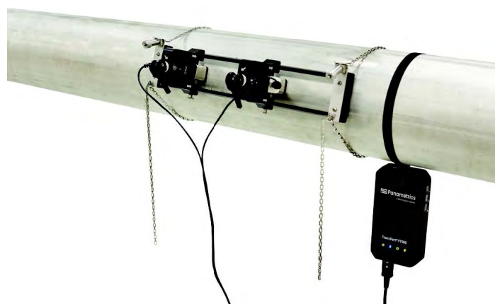
配管に取り付けられた取付治具、センサ、および、トランスミッタ
