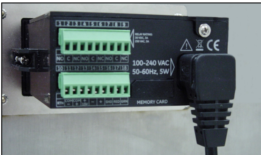
Рис. 39: Кабель питания от сети переменного тока подключен
