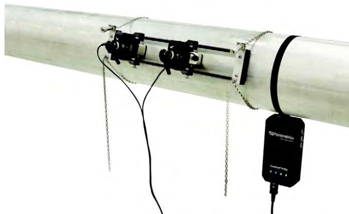
安装到管线上的夹具、换能器和传感器
