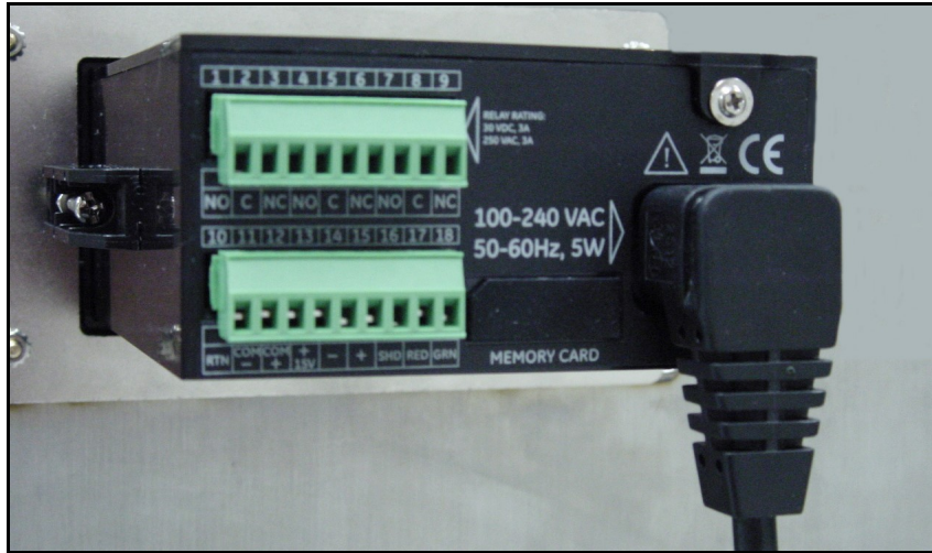
Figure 39: Câble d'alimentation CA branché
