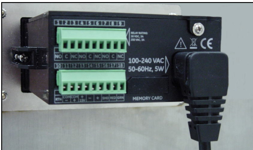
Figura 39: O cabo de força CA instalado
