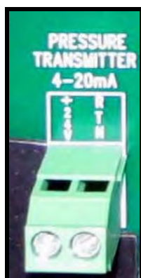
図29：圧カトランスミッタの接続部
