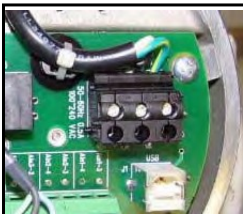
図26：電源端子ブロック
